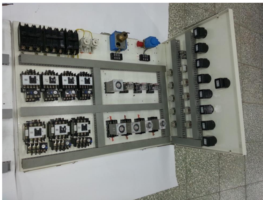
圖 5 器具盤-1 與操作盤全視圖（參考用）
